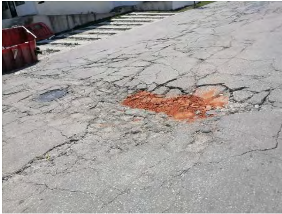
IMAGEN 10: fuente: Luis Daniel. - Vista de oriente a poniente donde los registros han sido afectados en gran manera debido al hundimiento que han tenido.
