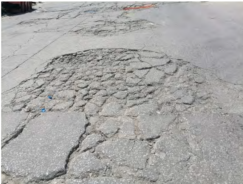
IMAGEN 2: fuente: Rogelio Alexis. - Vista de oriente a poniente en esta avenida los vehículos se ven realmente afectado debido a los baches en la manzana 7.
