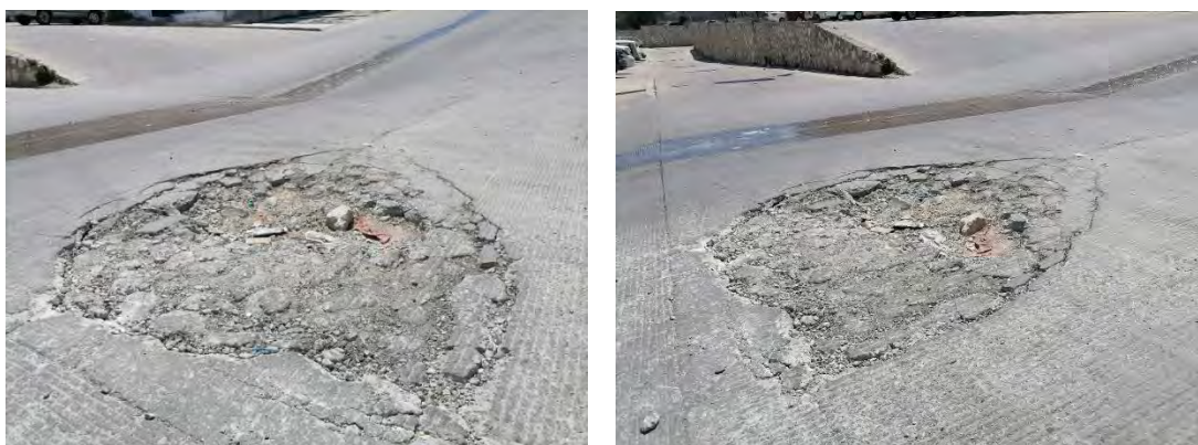
IMAGEN 5: fuente: Luis Daniel. se puede observar un bache de gran profundidad que afecta la vialidad.
