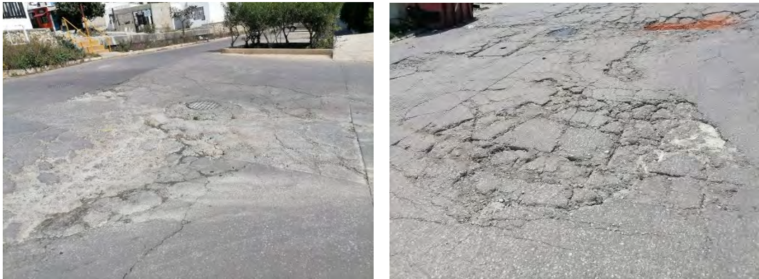
IMAGEN 3 y 4: fuente: Rogelio Alexis. - En este apartado la imagen de la derecha se encuentra un bache de gran magnitud de aproximadamente 2 m de largo por 1 m de ancho.
